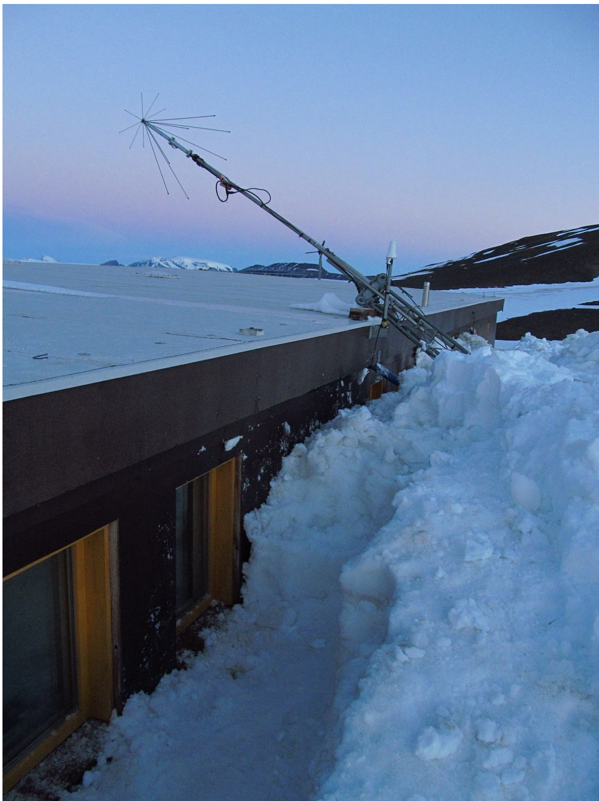
Foto_3: Ani o půlnoci druhého dne není práce zdaleka hotova – pohled na část stanice J.G. Mendela se sklopeným telekomunikačním stožářem, která je jen zvolna vysvobozována ze sevření sněhové návěje. Foto: K. Brat.
