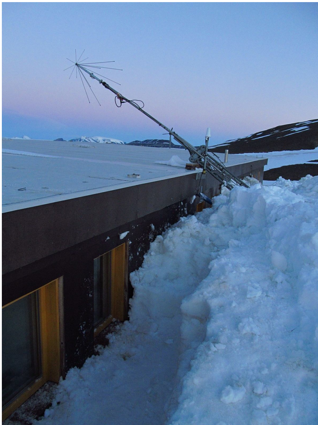
Foto_3: Ani o půlnoci druhého dne není práce zdaleka hotova – pohled na část stanice J.G. Mendela se sklopeným telekomunikačním stožárem, která je jen zvolna vysvobozována ze sevření sněhové návěje. Foto: K. Brat.
